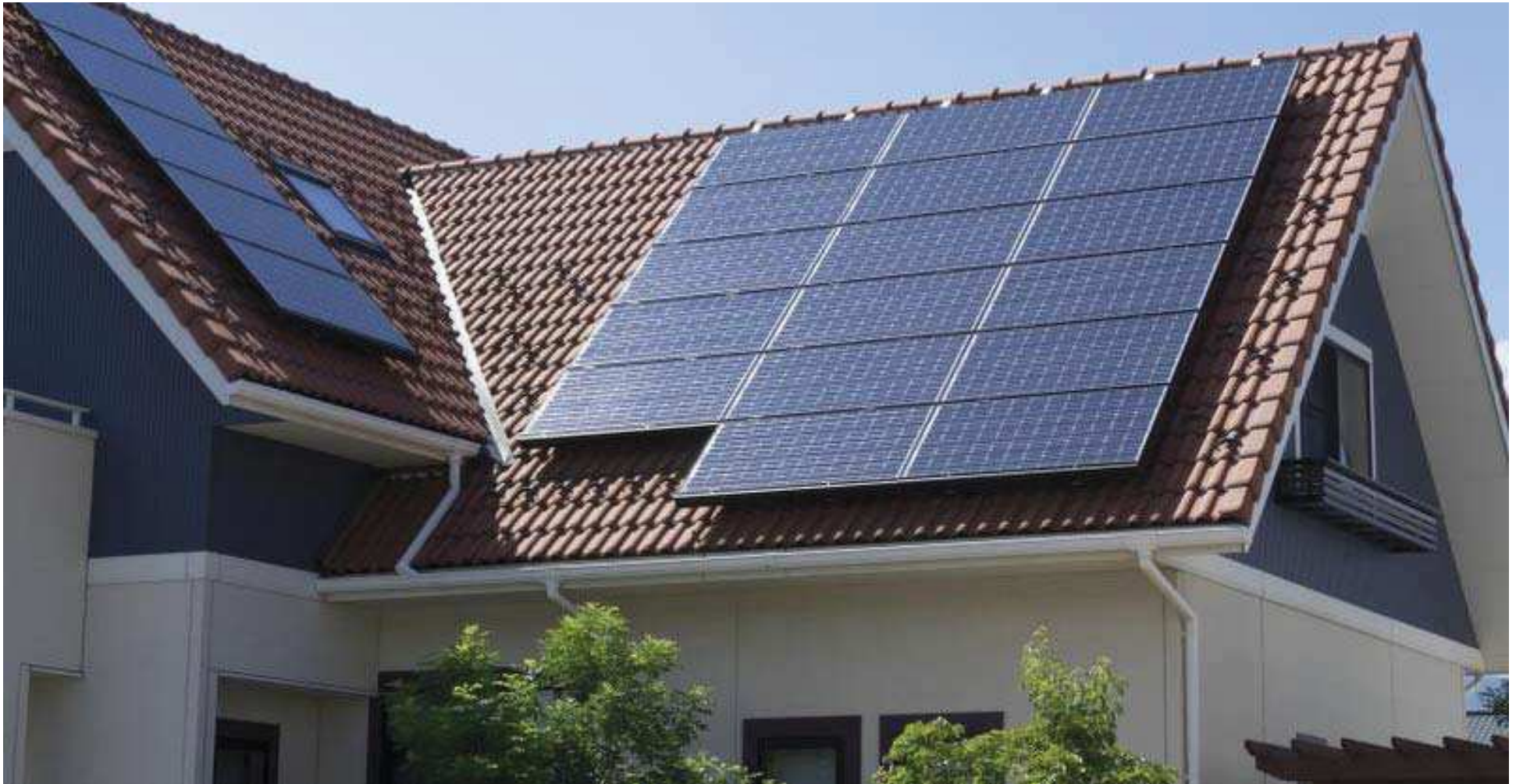
Dans les Ardennes, trois centrales villageoises vont produire de l'électricité à partir de panneaux photovoltaïques.
